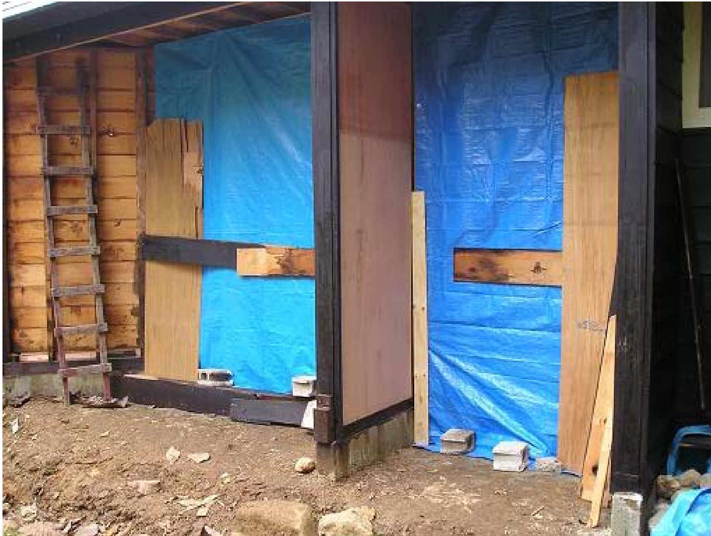
小屋北側 杉板張り必要
