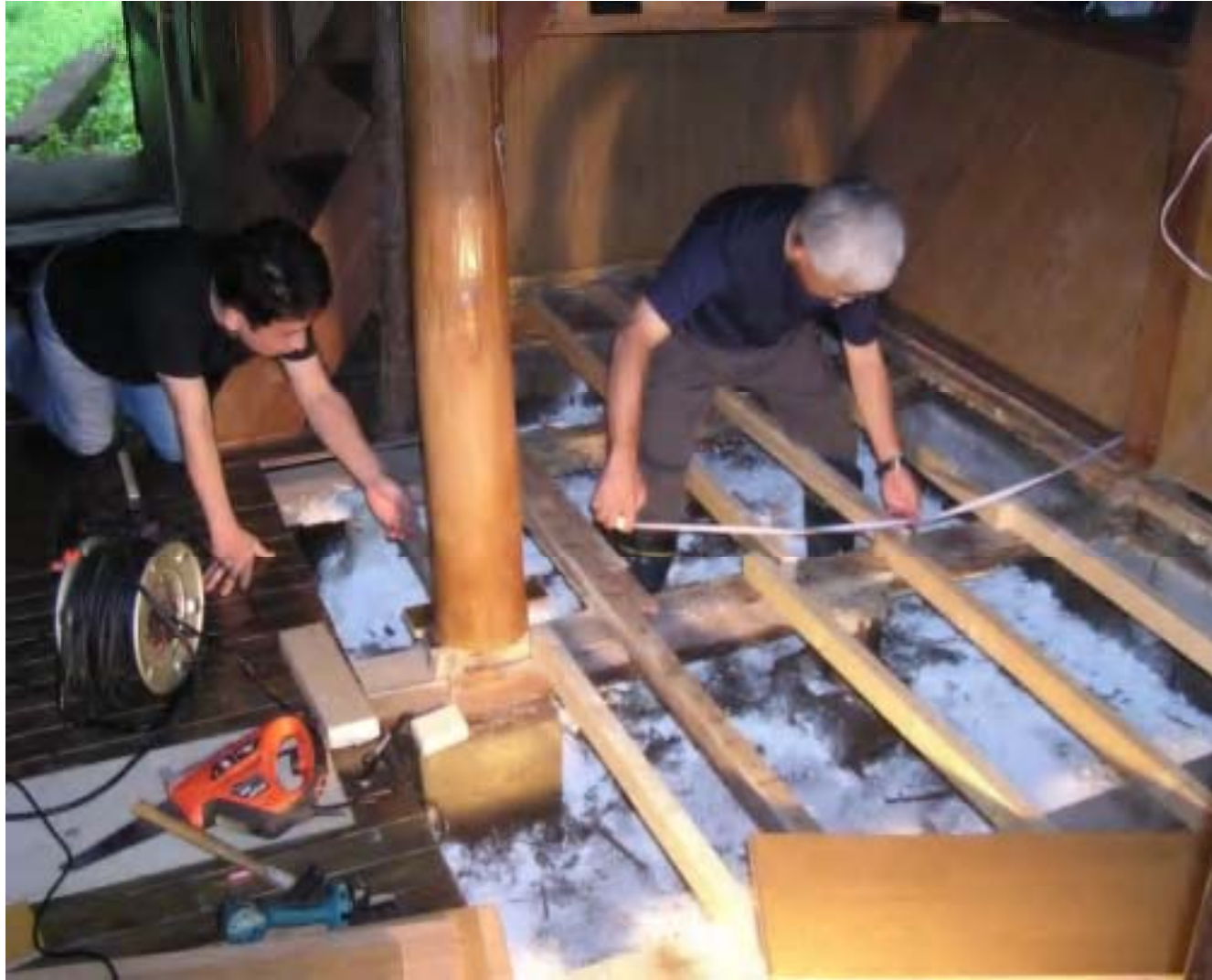
小屋内部 北側床を剥がした状態 白い粉は石灰
